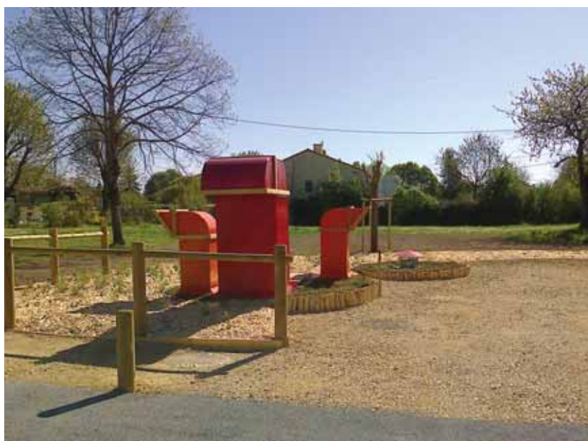
Figure 2 : poste Refoulement Amuré
