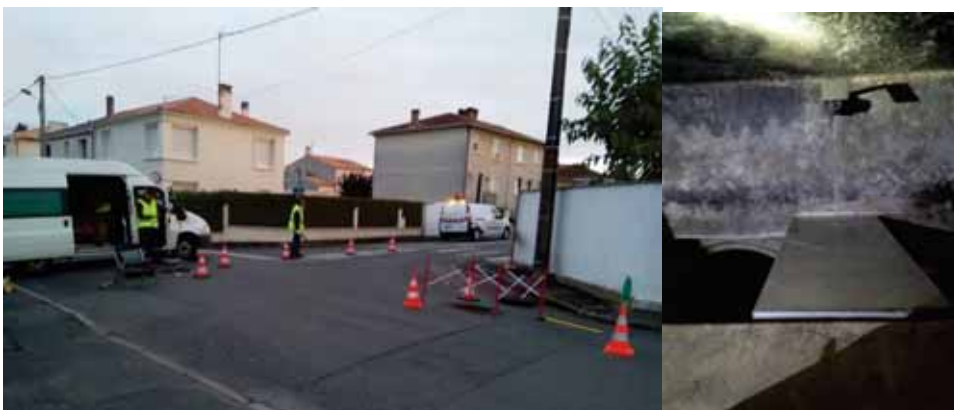
Contrôle avec étalonnage d'un point autosurveillance réseau (DO Jean Macé à Niort)
